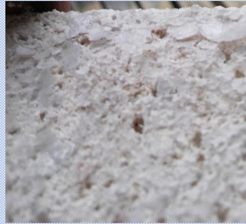
Powierzchnia próbki zabezpieczanej szkłem wodnym – widoczne odspojone „łuski”
