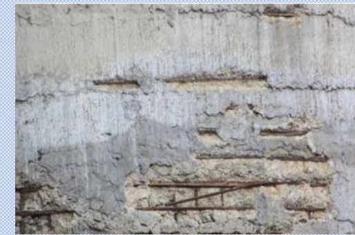
Widok korodującego betonu i zbrojenia
