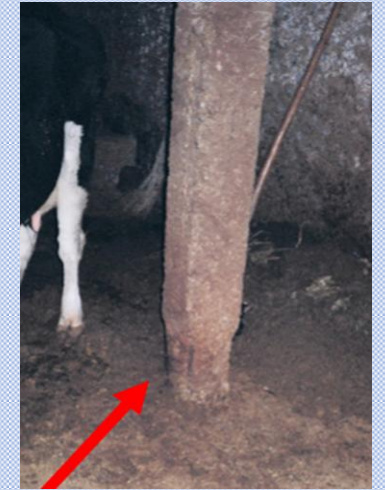
Korozja wywołana kwasami organicznymi w oborze na słupie żelbetowym
