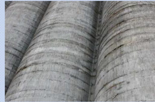
Widok pęknięć na połączeniach technologicznych przy betonowaniu
